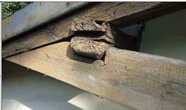
Fot. Z_39. Fragmenty płatwi wychodzące „na zewnątrz” obiektu silnie skorodowane biologicznie.
