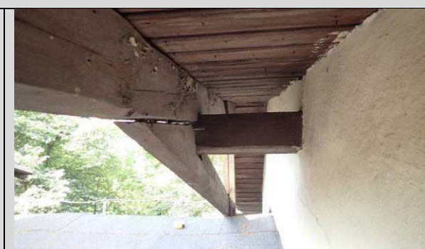
Fot. Z_33. Pojedyncze elementy więźby wymienione w okresie eksploatacji obiektu (tu „nowa” jętka). Wymienione elementy nieprawidłowo spasowane.
