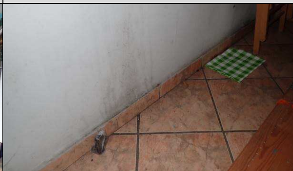
Fot. W_49. Przykładowe zawilgocenie strefy cokołowej wewnątrz obiektu.
