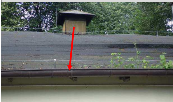
Fot. Z_3. Przykładowa nieszczelność systemu orynnowania: tu nieszczelność rynien w miejscu połączenia.
