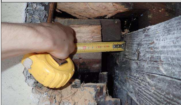
Fot. 01_5. Wartość względnego przemieszczenia belek wieńczących - 6cm.
