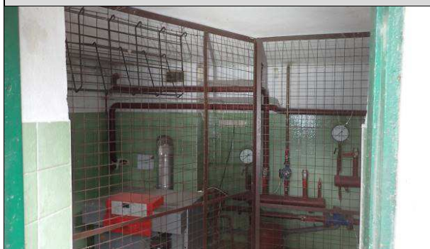
Fot. W_54. Jedno z pomieszczeń piwnicznych zagospodarowane na potrzeby wykonania węzła cieplnego.
