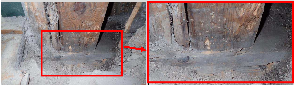
Fot. 04_4. Widoczne zmiażdżenie podwaliny pod słupem.
