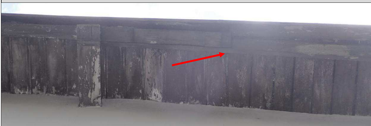
Fot. Z_23. Na krokwi szczytowej, w miejscu połączenia części pierwotnej i przybudówki widoczne złącze nakładkowe z deski.
