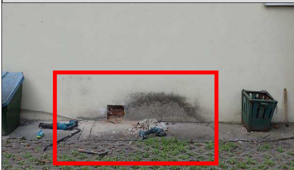
Fot. O5_1. Miejsce wykonania odkrywki – widoczne zawilgocone powierzchnie elewacji.
