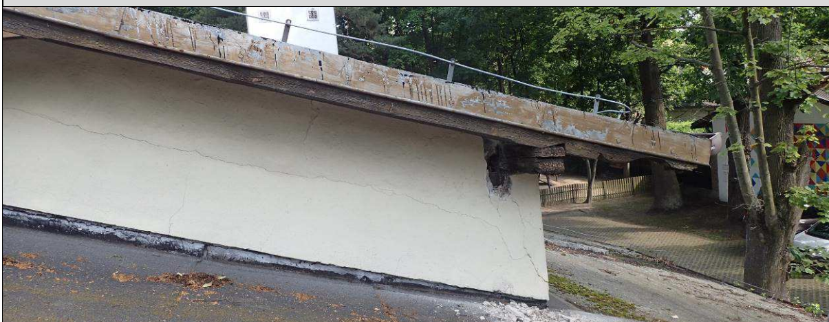
Fot. 01_1. Lokalizacja wykonanej odkrywki - Widoczne zarysowania elewacji mogące świadczyć o nieprawidłowościach w pracy konstrukcji.
