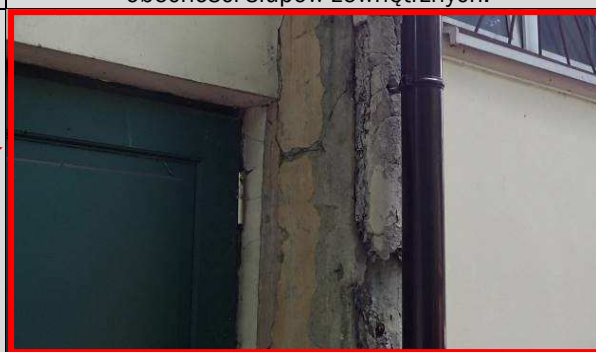
Kadr fot. Z_15. Obserwuje się miejscowe odspojenia płyt suprema.
