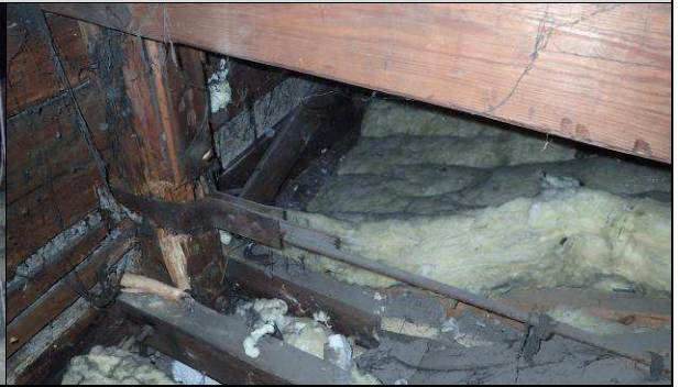
Fot. P_21. W osi dwóch wiązarów widoczne (wtórne) ściągi stalowe.
