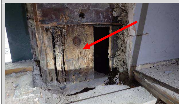
Fot. 04_2. Podstawa słupa w średnim stanie technicznym.
