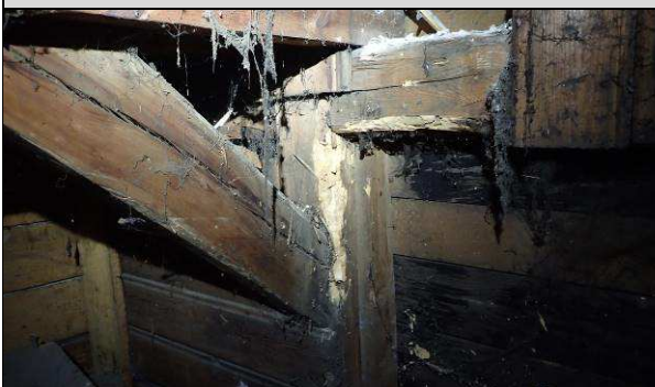
Fot. P_46. Przykładowe uszkodzenie biologiczne słupa.
