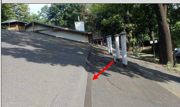
Fot. Z_31. Widoczna różnica wysokości między dachem oryginalnym i dachem dobudówki. W miejscu uskoku brak deski ukosującej załamanie połaci.
