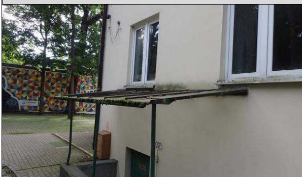
Fot. Z_12. Daszek nad wejściem do piwnicy w złym stanie technicznym.
