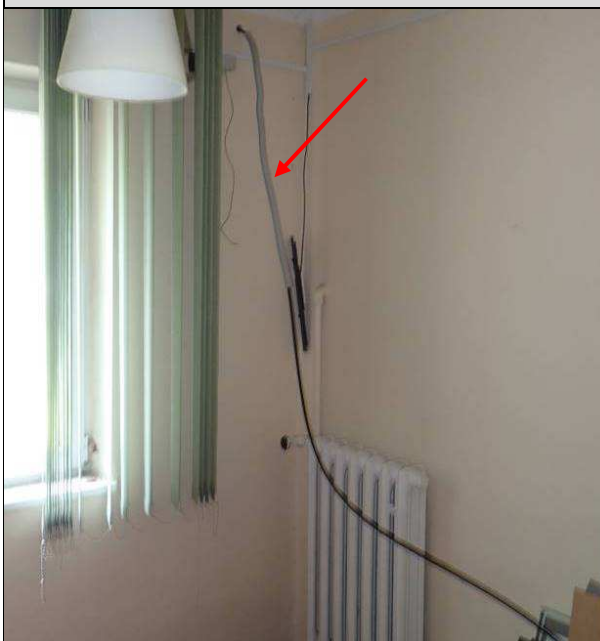
Fot. W_12. Widoczne prowizoryczne przyłącze instalacji elektrycznej.
