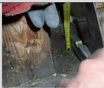
Fot. 04_7. Stwierdzona wartość deformacji podwaliny w miejscu docisku: ok. 1,5cm.
