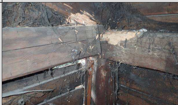
Fot. P_16. Obserwowana silna korozja biologiczna belki wieńczącej w narożu.
