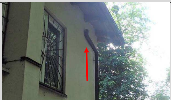
Fot. Z_17. Przykładowa nieszczelność systemu orynnowania: tu nieszczelne połączenie rury spustowej ze sztucерem.
