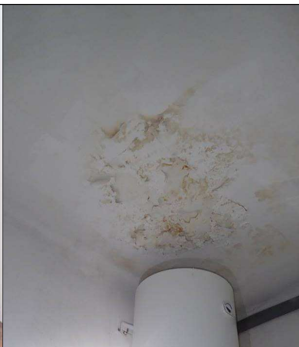
Fot. W_39. Przykładowe zawilgocenie stropu.
