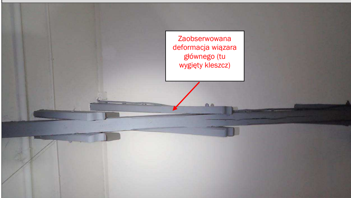
Fot. W_11. Część elementów wiazarów głównych zdeformowana.
