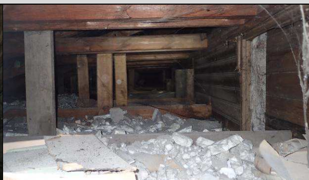
Fot. P_57. Na ślepej podłodze balast z odpadów budowlanych.
