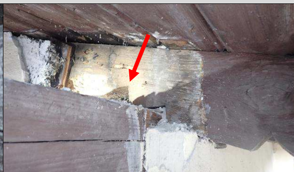
Fot. 01_3. Widok wzajemnego przemieszczenia krokwi i belki wieńczącej.
