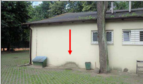
Fot. Z_5. Przykładowe zanieczyszczenie elewacji w miejscu nieszczelności systemu rynnowego.
