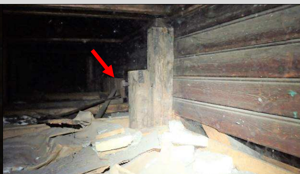
Fot. P_68. Widoczne dodatkowe podwójne słupy drewniane „dostawione” przed oryginalnym szalunkiem elewacji. Dostawione słupy zespolone z oryginalnymi poprzez skręcenie. Na przedmiotowej fotografii śruba „niedokręcona”.
