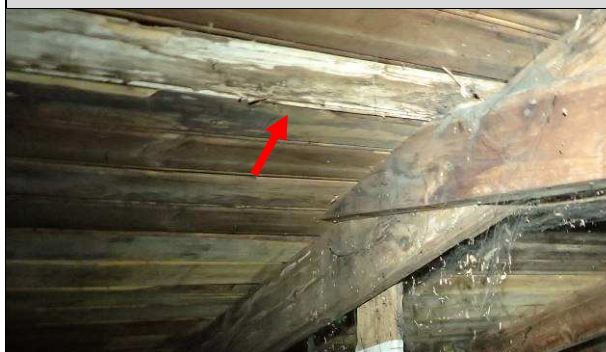
Fot. P_75. Obserwowane miejscowe uszkodzenia deskowania dachu.
