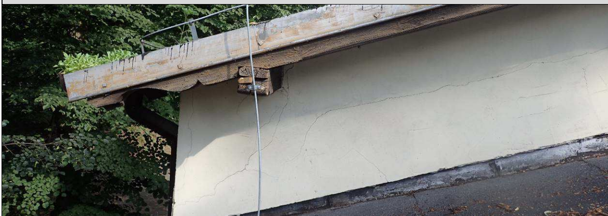
Fot. 02_1. Lokalizacja wykonanej odkrywki - Widoczne zarysowania elewacji mogące świadczyć o nieprawidłowościach w pracy konstrukcji.
