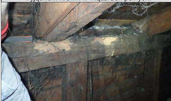
Fot. P_18. Obserwowana lokalna korozja biologiczna belki ściennej wieńczącej.
