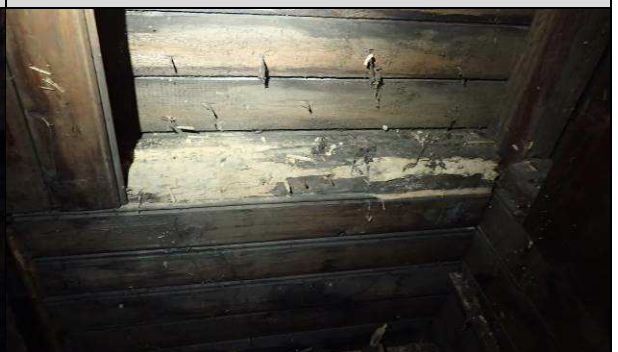
Fot. P_48. Przykładowe uszkodzenie biologiczne rygla ściennego.
