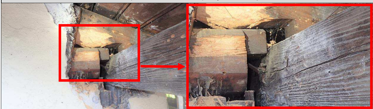
Fot. 01_4. Widoczne wzajemne przemieszczenie elementów (tu wzajemne przemieszczenie dwóch belek wieńczących). Elementy więzby z wyraźnymi oznakami korozji biologicznej
