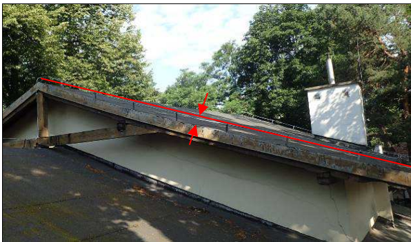
Fot. Z_32. Widoczne ugięcie krokwi będące skutkiem nieprawidłowego spasowania jętki.
